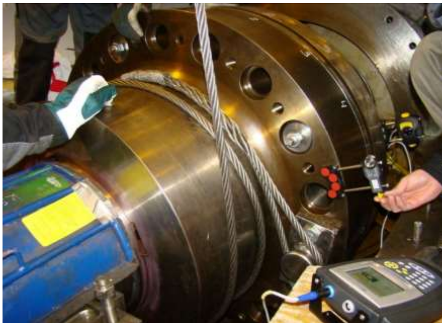
Рампа Energia Central Piedra Buena S.A., Аргентина. Центровка роторов.
