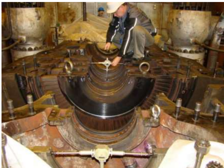
Филиал ПАО ОГК-2 Киришская ГРЭС. Центровка проточной части ЦВД турбины К-300-240 ЛМЗ
