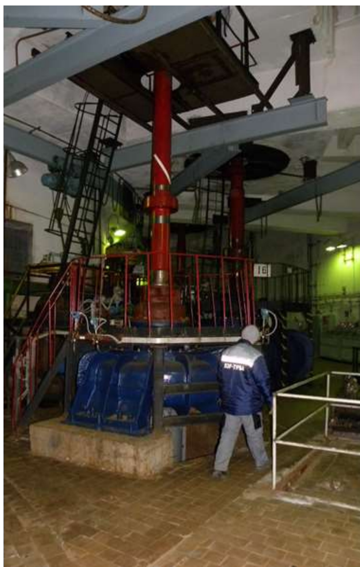
Главная насосная станция ССА (Ольгино)
